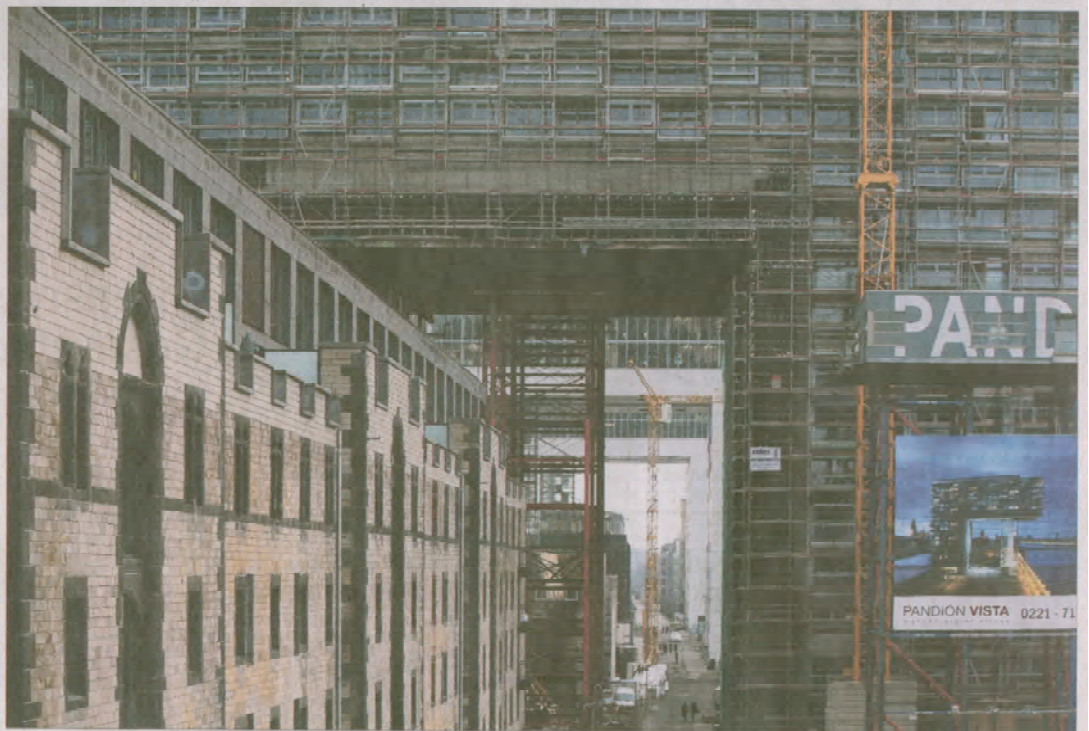
Im nördlichen der drei Kranhäuser wurde gestern Richtfest gefeiert. Im nächsten Herbst sollen die 133 Wohnungen bezugsfertig sein. (Foto: Schmulgen)
